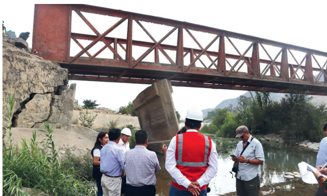
| Inspección técnica a puente colapsado
