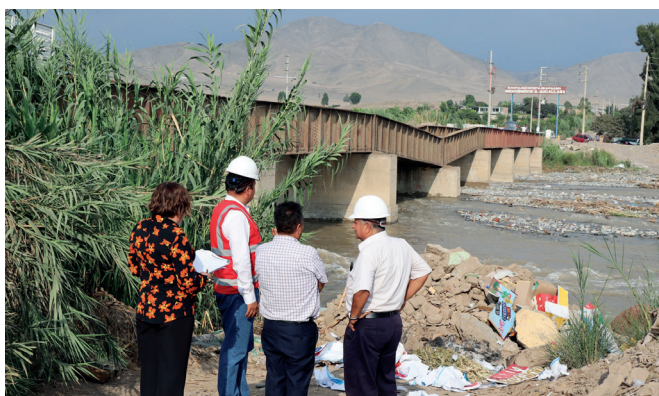
| Inspección técnica a puente colapsado
