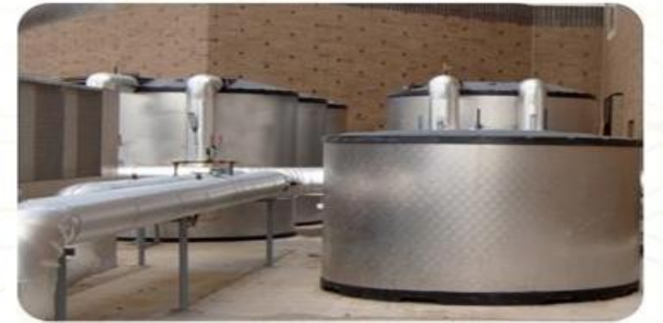
Tanques de Hielo
