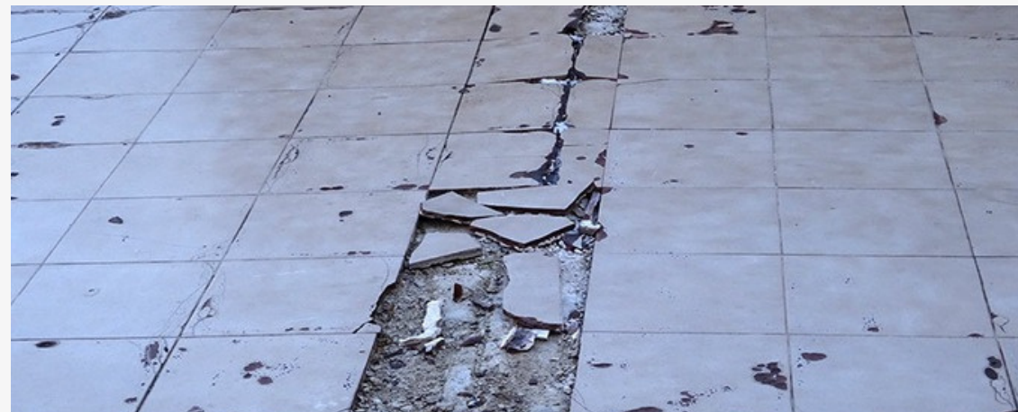
Piso en mal estado o desnivelado
